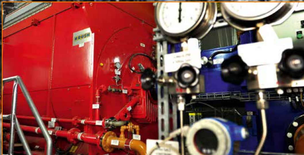
In drei Energiezentralen drehen sich künftig insgesamt vier Turbinen – hier die Turbine aus der Energiezentrale 2.
