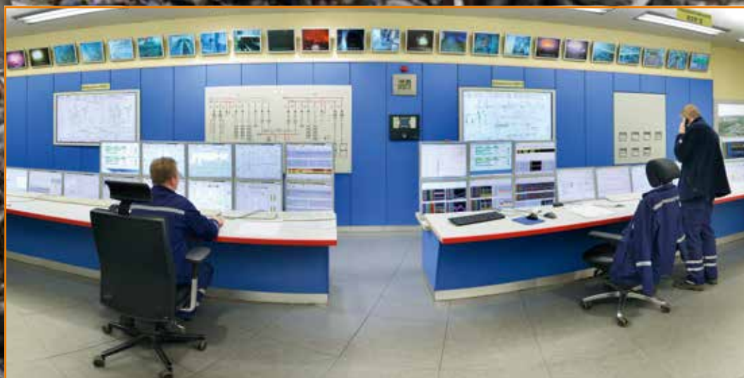
Kommandobrücke Schaltwarte: Hier laufen alle Fäden zusammen – voll digital mit zusätzlichen optischen und akustischen Signalen zur Funktionstüchtigkeit der Anlage.
