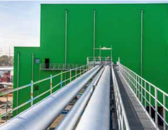
Durch diese Rohre wird der Dampf transportiert, der die Turbine für die Fernwärmeproduktion in der neuen Energiezentrale antreibt.
