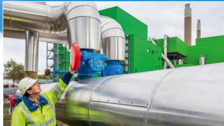
Alles dicht? Paul-Jürgen Severin prüft an den Fernwärmerohren, ob die Ventile zuverlässig arbeiten. Hier wird nichts dem Zufall überlassen.
