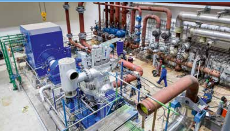
Blick von der Galerie in die neue Energiezentrale III.
