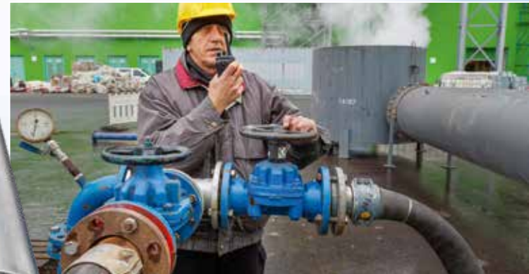
Alles in Ordnung? Bei den Reinigungsarbeiten der Dampfleitungen halten die Arbeiter ständig Kontakt über Funk. Die Absprachen untereinander sind besonders wichtig.
